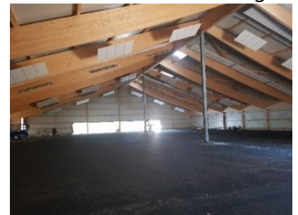
Unsere neue Anlage (Halle). Stand Januar 2021
